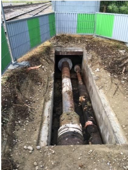
Exemple de constat de calorifuge détérioré et de tuyauterie corrodée suite à un sondage en caniveau
