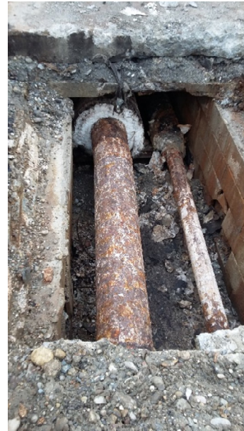
Exemple de constat de génie civil détérioré et de tuyauterie corrodée suite à un sondage en caniveau
