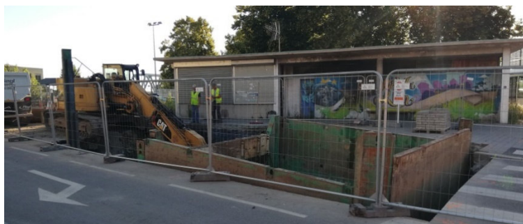
Terrassement d'une fosse de forage sous tram au port du Rhin – R-CUA
